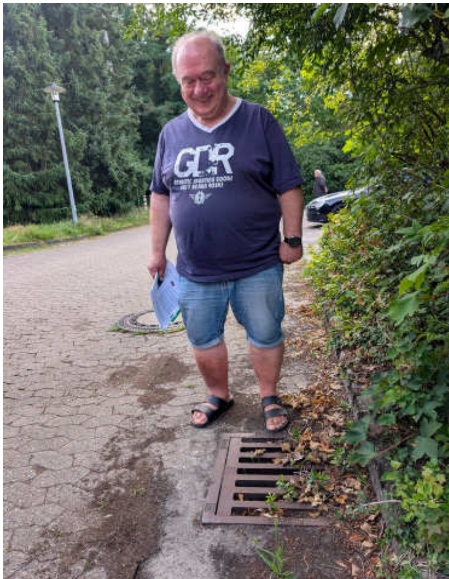
Ulrich Rohleder an einem defekten Gullydeckel. Foto: Franz Purucker
